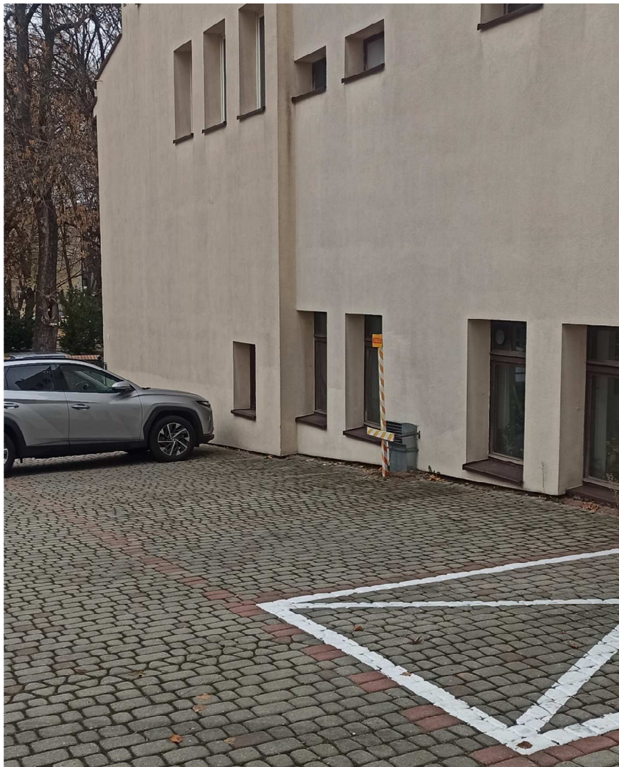
Widok parkingu od strony zalewanej ściany piwnicznej (brak przeciw spadków od str budynku)
